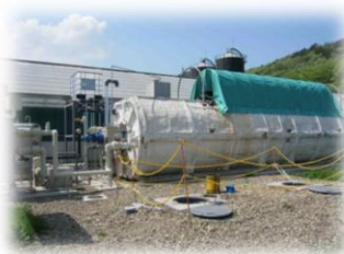
メタン発酵槽
